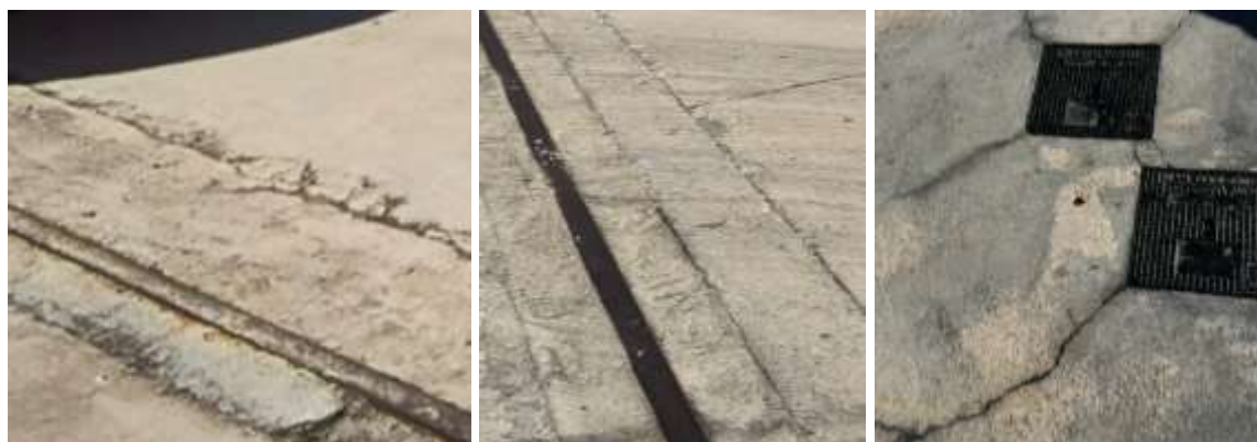
Figura 8. Fisuración superficial del pavimento en la zona de concesión
