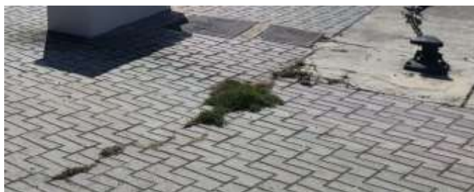
Figura 13. Daños en el pavimento en la zona de concesión, con vegetación creciendo entre las grietas
