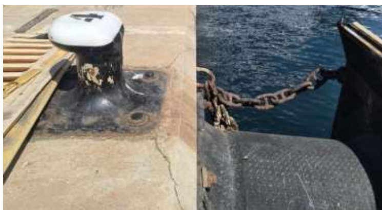
Figura 6. Daños identificados en el cantil del muelle, en el entorno de la zona de concesión
