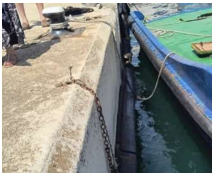
Figura 9. Daños identificados en el equipamiento náutico existente, en el entorno de la zona de concesión
