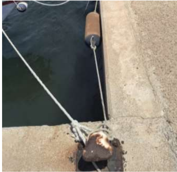
Figura 16. Daños identificados en el equipamiento náutico existente en la zona de concesión
