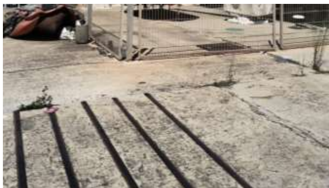
Figura 10. Fisuración superficial del pavimento en la zona de concesión, con vegetación creciendo entre las grietas
