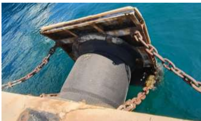
Figura 7. Daños identificados en el equipamiento náutico existente, en el entorno de la zona de concesión
