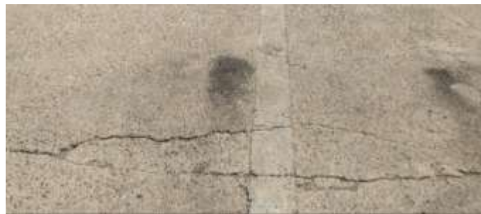
Figura 17. Daños menores en el pavimento en la zona de concesión
